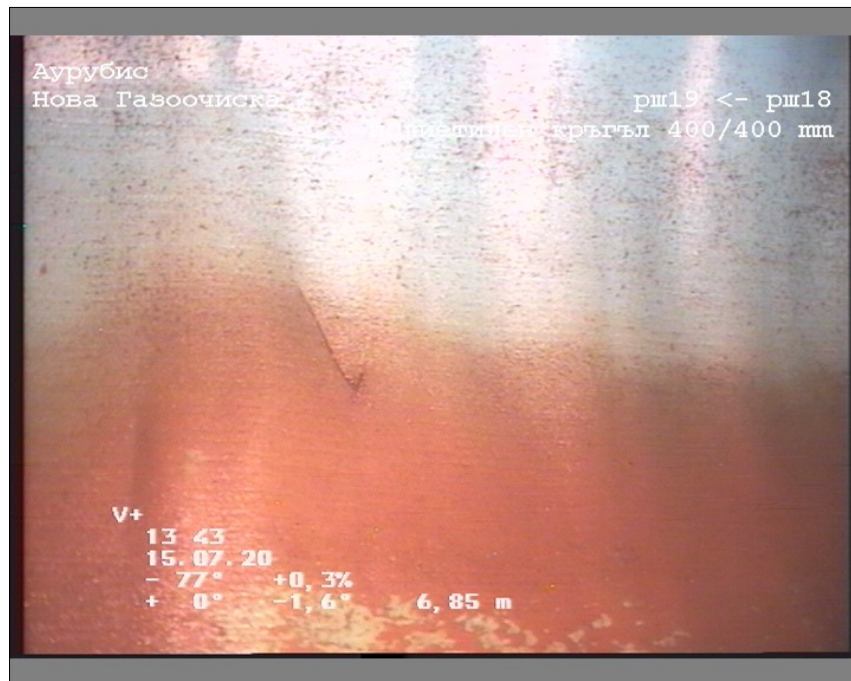
Снимка: 7_4А, Носител данни №: 15.7.2020 г._0, 00:02:51 6,85m, Повърхностни пукнатини: повърхонстни/паяжовидни/ по обхвата на тръбата %RissbreiteMM%, от 9 до 10 Часа
